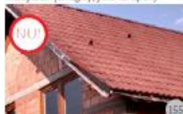
Fig.155. AȘA NU: Folosirea țiglelor „marf” din beton vopălit este total neadecvată. Sunt multe situații în care acestea s-au decolorat, nemălinând cont de aspectul nepotrivit al formei importate.
