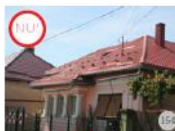
Fig.154. AȘA NU: Folosirea tablei ridică o gamă largă de dificultăți plecând de la problema reciclării ei până la probleme de onestitate: imitarea prin culoare și formă a țiglei ceramice. Cele mai mari probleme rămân însă cele legate de aspect, de încălzire excesivă, care poate crea un disconfort vara într-o mansardă locuită, și de zgomot pe timp de ploaie sau grindină. În cele din urmă, tablea este un material lețin, importat din zona construcțiilor industriale, unde până de curând nu a contat aspectul finisajului. (Drăguș, jud. Brașov)
